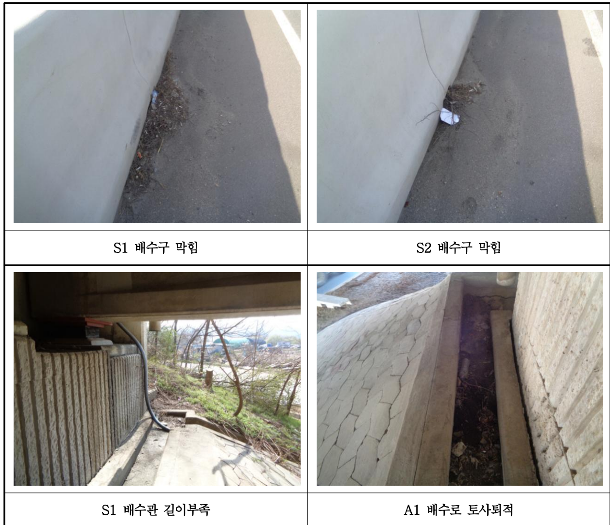
【사진 2.3.20】 배수시설 손상현황
